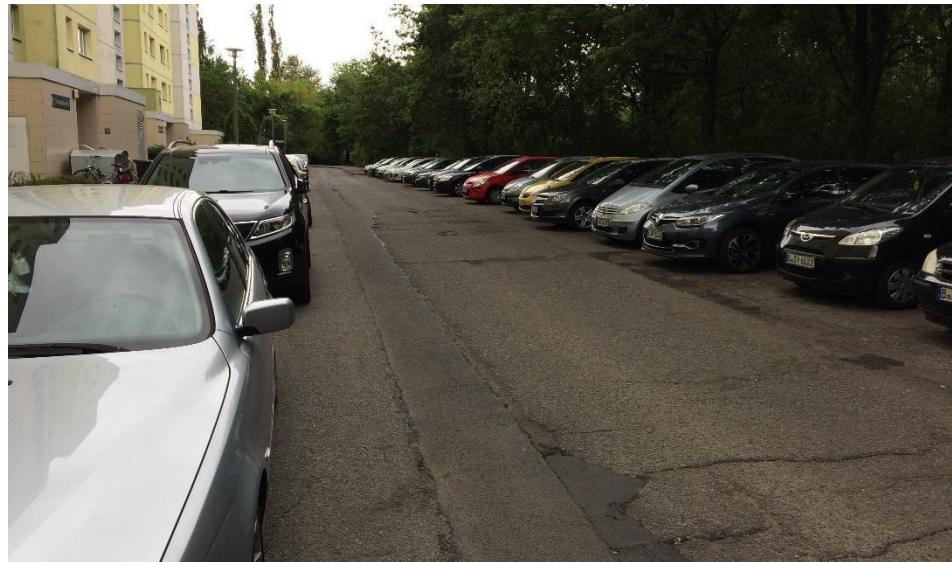
Abbildung 32: Asphaltbelag mit Mängeln in der Thomas-Mann-Straße
