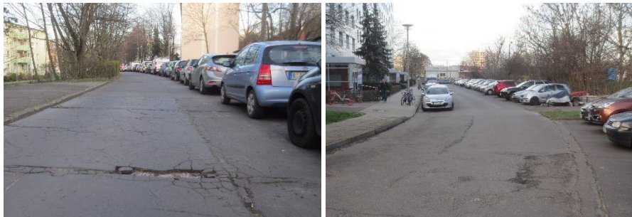
Abbildung 88: Oberflächenschäden in der Einsteinstraße
